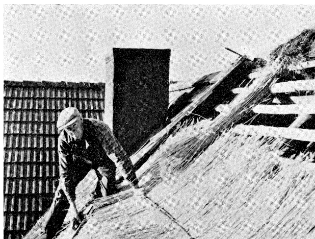
42. Taktäckning i Värö sn, Viske hd, Halland. Taktäckaren är i färd med att "driva" taket, man ser det på vrakans ställning, som han håller i sin högra hand. Foto Anders Johansson, Ambjörntorp 4, 1947.
