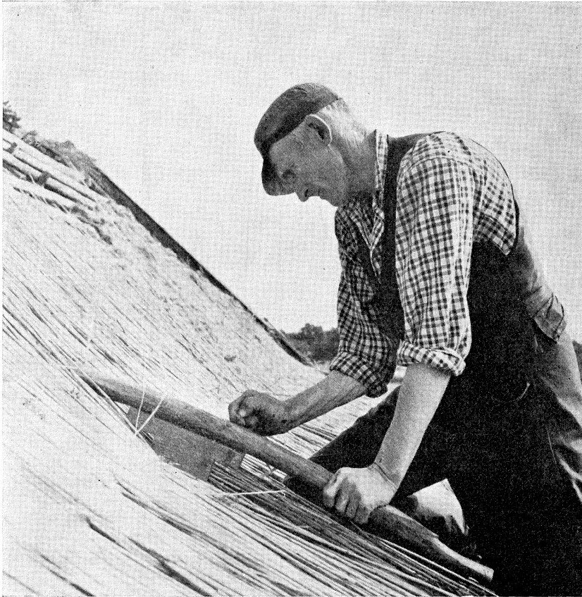
71. Vasstäckning av lada, Lövä, Ålems sn, Stranda hd, Småland. Täckaren arbetar med tryckstaken. Foto Nils J Nilsson 1954.
